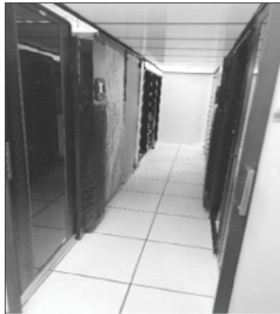
क्लाउड एसले कन्टेनमेंट पेसेज इन बिटविन सर्वर रेक्स
